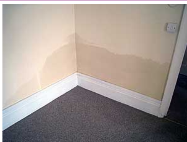
Podciąganie wilgoci z poziomu podłogi przed uszkodzeniem otynkowania.
