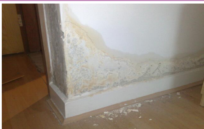
Ściana podciągana wilgocią z osadami soli i kruszącym się tynkiem.
